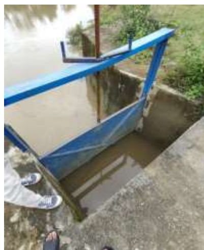
Gambar 1. Pintu irigasi air (Sumber: Penulis, 2024)
